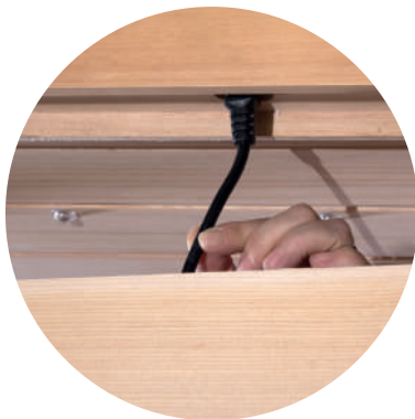
Ukázka protažení kabelů
